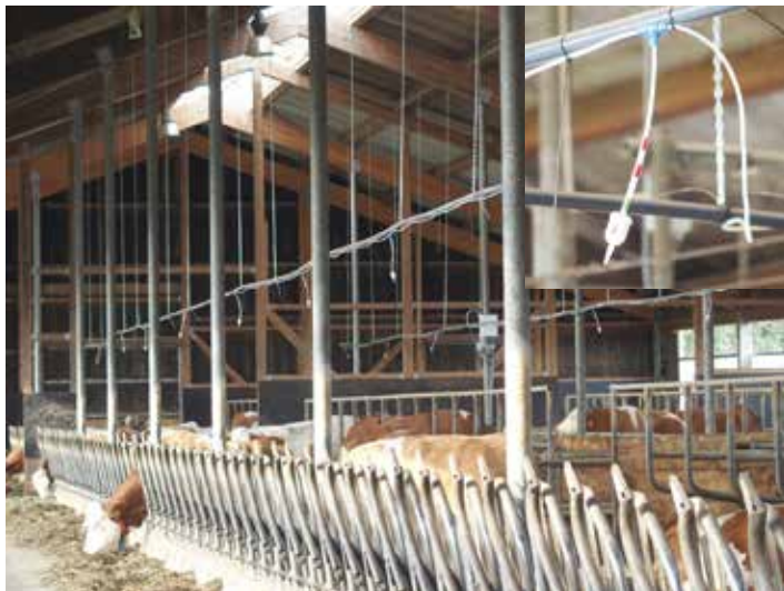
Abb. 2: Messleitung mit Probenahmepunkten über kritische Kapillaren im Milchviehstall (© Eurich-Menden)
